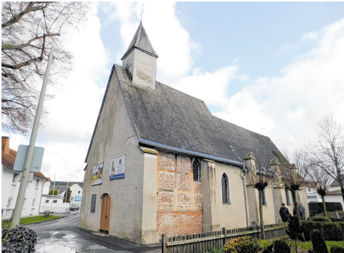
Eine Außensanierung der Rodentelgenkapelle ist erforderlich. Bei der vergangenen Innensanierung mussten wegen morschen Fachwerks neues Mauerwerk und neue Balken gesetzt werden. Nebendran hat der Außenputz Risse. FOTO: SCHWARZ
