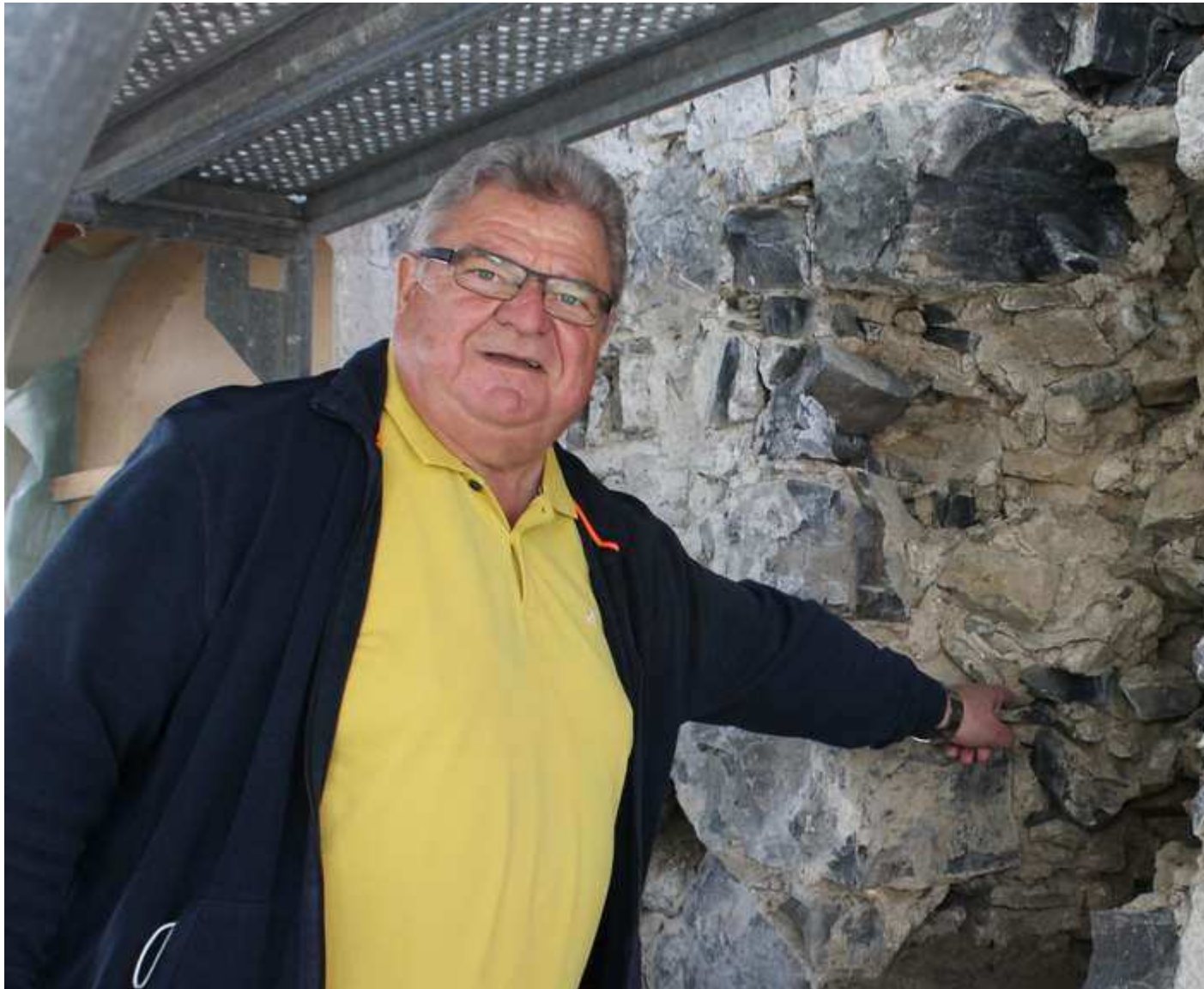
Norbert Hollmann zeigt die Schäden in den Bruchsteinmauern.
