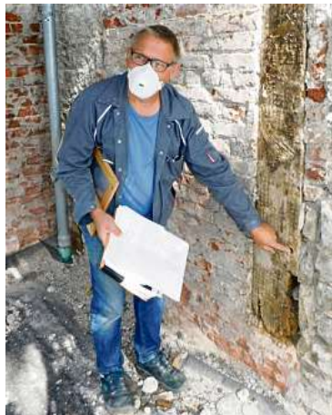
LWL-Bauforscher Peter Barthold zeigt auf einen feuchten Fachwerkbalken, der von einem Käfer geschädigt wurde. FOTO: M. SCHWARZ
